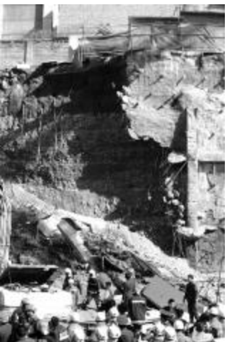
现管涌或基底隆起而发生安全事故。
