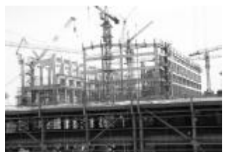
▲大连红沿河核电项目2号主厂房比合同规定工期提前三天开始吊装钢结构屋架。 古乐/摄
